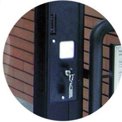
KAT KONTROL PANELİ
