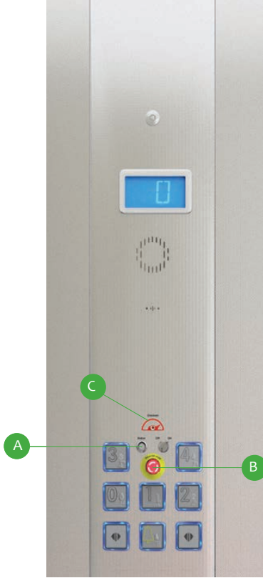
Kabin içi kontrol paneli
